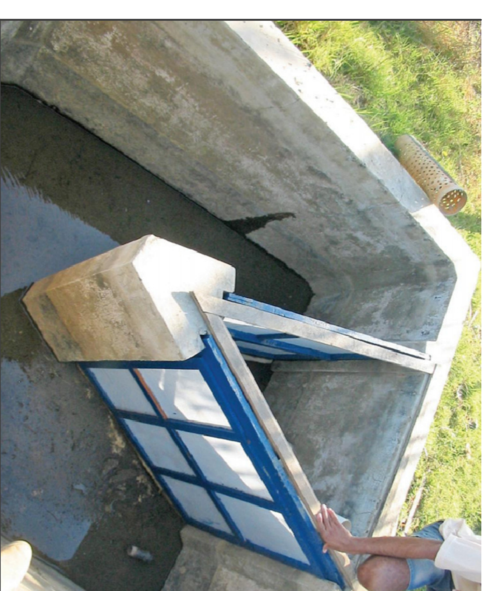
SISTEMA DE FILTRAGEM COM TELAS
